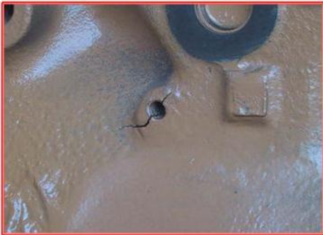
15. Aqui está um furo rachado na parede lateral do bloco de motor.
